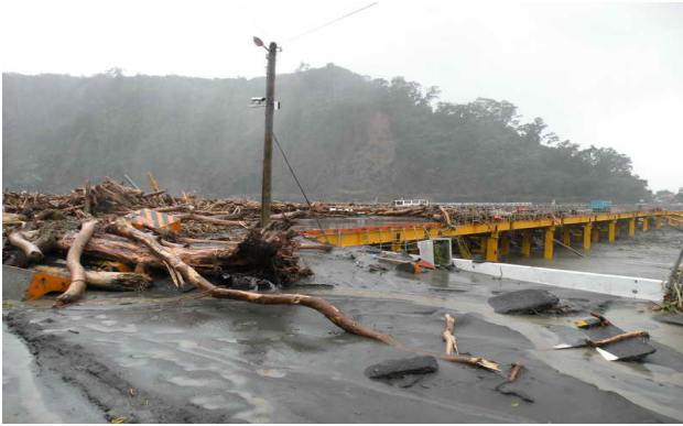
圖6 漂流木堆滿橋面(高雄六龜大津橋)
