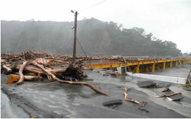
圖6 漂流木堆滿橋面(高雄六龜大津橋)
